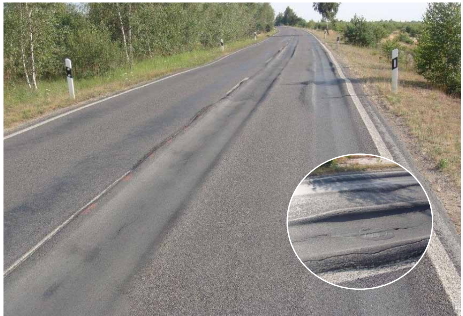
Die L 60 zwischen Lauchhammer und Finsterwalde ist seit gestern gesperrt. Das Geld für eine Straßenerneuerung fehlt. Geld, das die rot-rote Landesregierung lieber für Prestigeprojekte ausgibt, um gut dazustehen.
